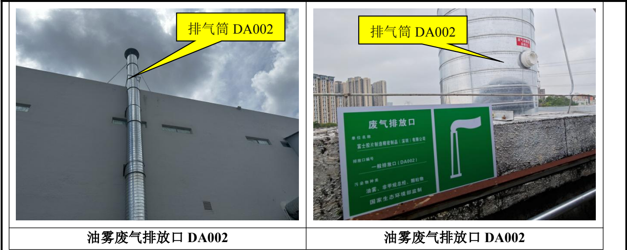
图 2-2 废气处理设施照片
